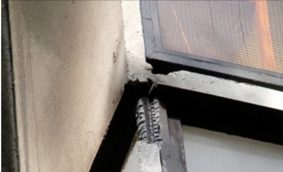
Vasbeton szerkezet sérülése tűz, illetve hő hatására
